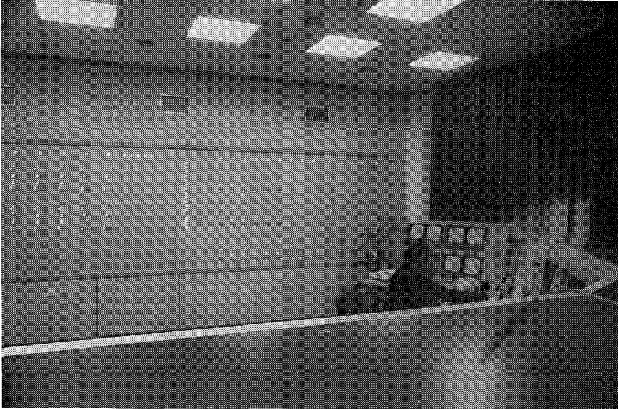
Overzicht van het lichttableau in het zenderbedrijfcentrum Lopik.
